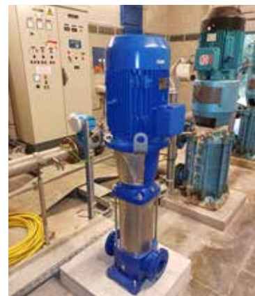
nouvelle pompe Lamouline
